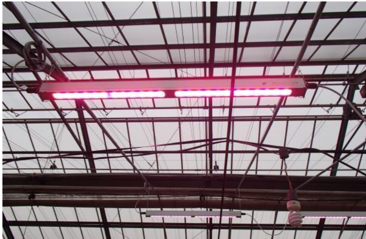
図1 設置したLEDライト
