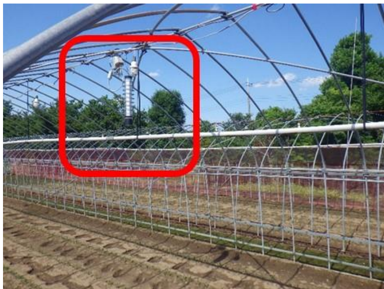
写真11 緑色LEDの設置状況
