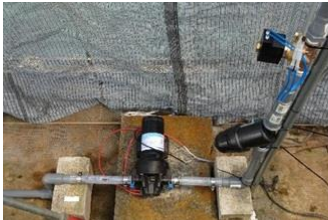
図9 実証区の加圧ポンプ、フィルター、電磁弁等
