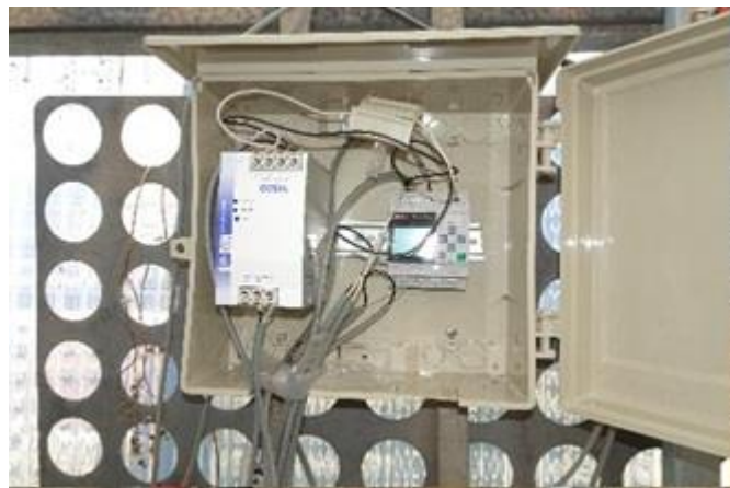
図11 実証区簡易ミストのコントローラ、電源ユニット等
