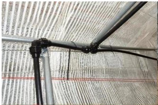
図10 簡易ミスト給水用のPEパイプの配管
